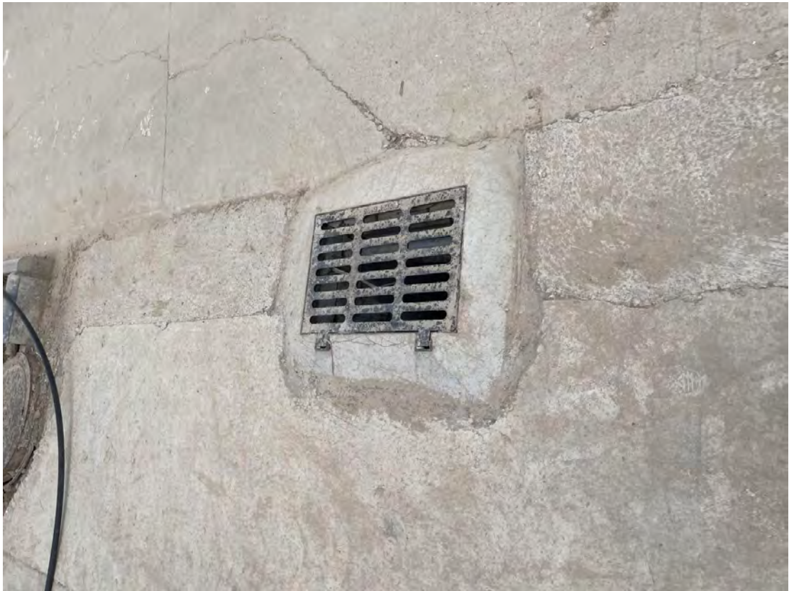
雨水管网（拍摄时间：2021年9月）
