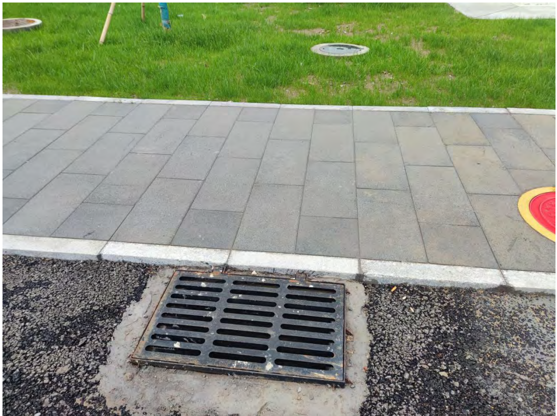
雨水管网（拍摄时间：2021年10月）
