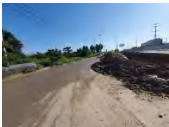
堆土未拦挡造成周边市政道路泥土污染
