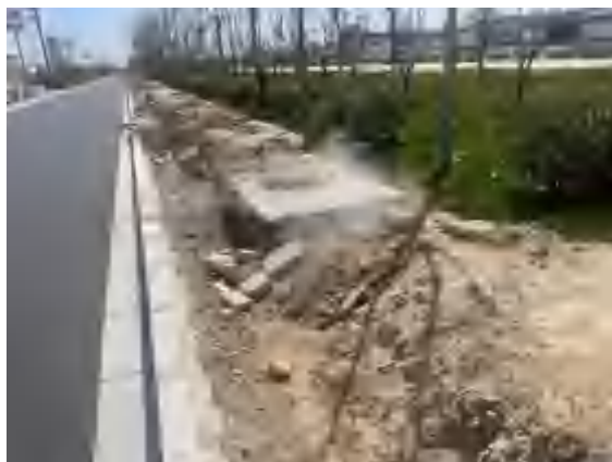
裕翔路管线上方裸露
