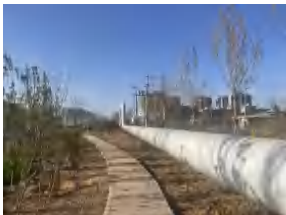
西外环路工业蒸汽管道下方地表裸露
