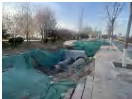
柴武大道部分区域管线未回填
