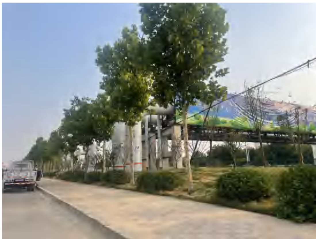
已建好的架空线路
