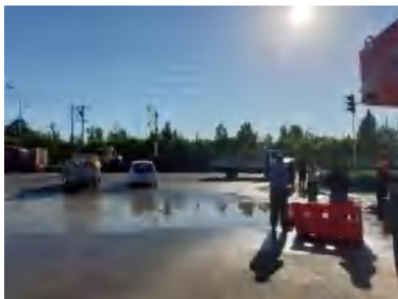
由于管网施工造成泥水漫流
