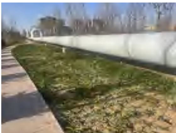
西外环路管道下方植被长势较差
