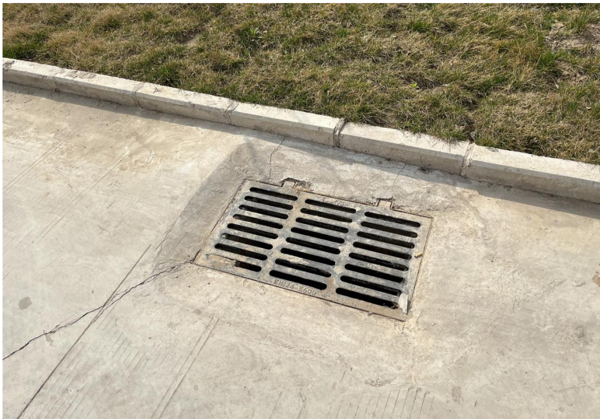
雨水管网（拍摄时间：2022年3月）
