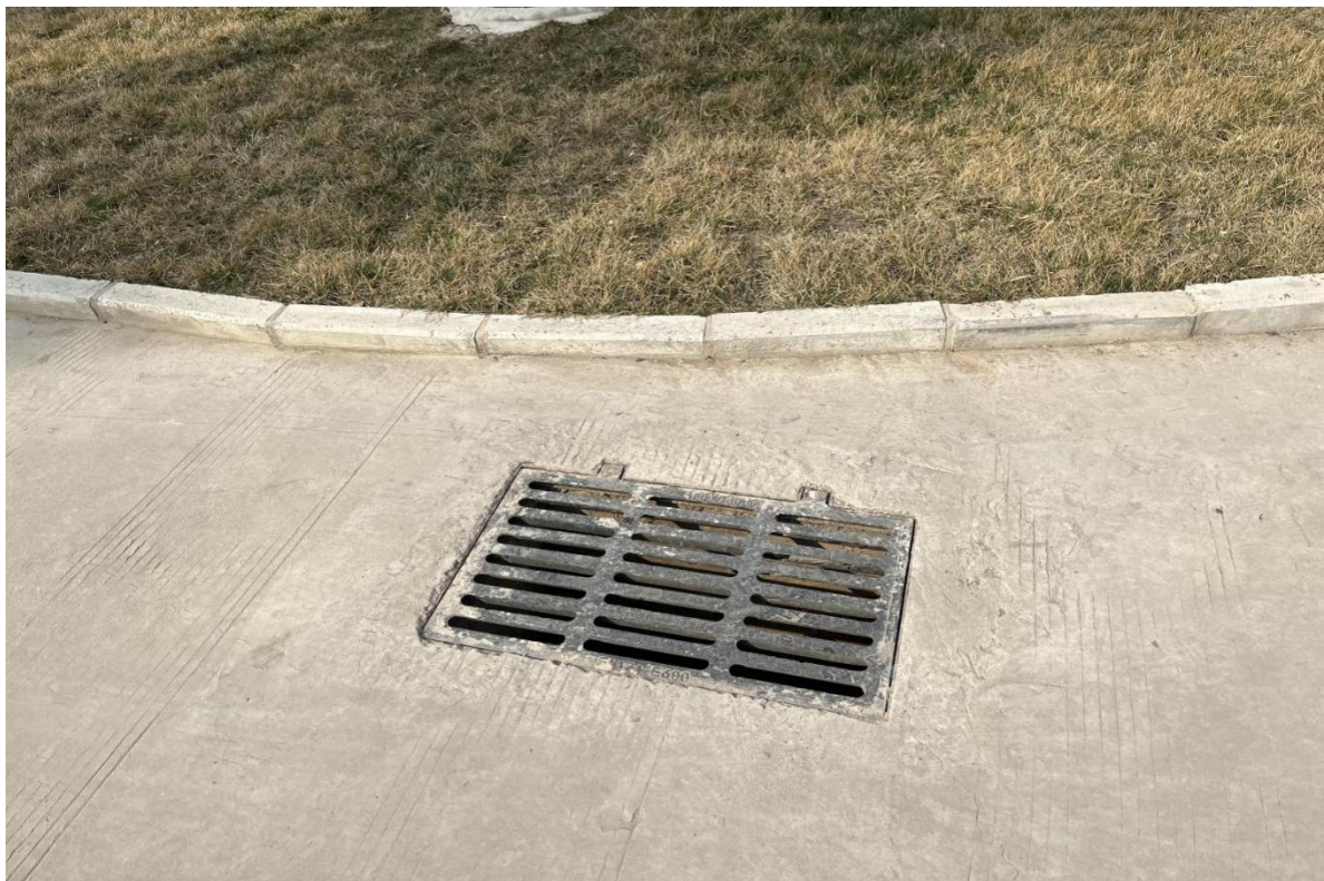
雨水管网（拍摄时间：2022年3月）
