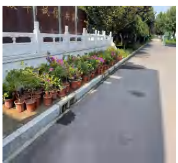
办公生活区-雨水管
